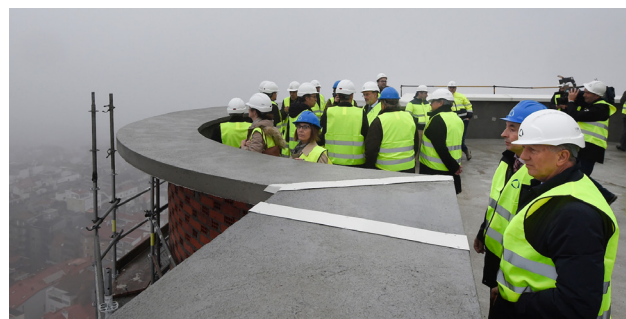
El decano visitó las obras de la nueva ciudad de la Justicia el 30 de julio y el 30 enero de 2020
